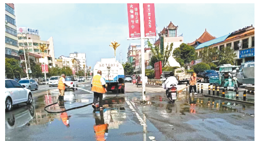
6月27日,一场强降雨过后,太康县城部分路段积水。县城管局组织环卫工人开展大规模冲洗、清扫、清淤行动,消除道路安全隐患,营造了整洁、靓丽的城市环境。记者张洪涛摄
