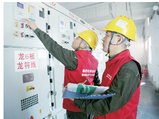
巡检人员在巡查电力设备。
